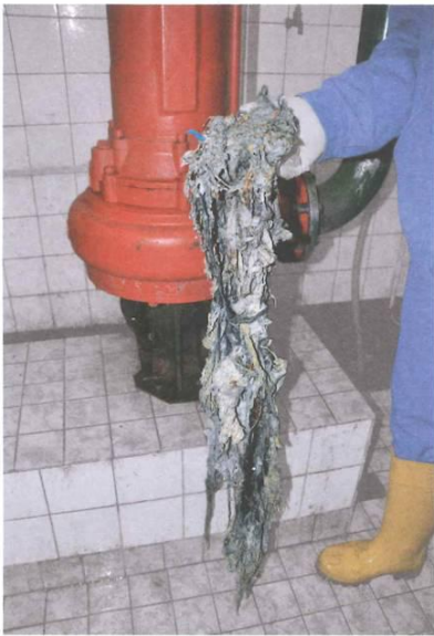
Sieht übel aus und ist es auch: verfilzte Feuchttücher. Regelmäßig legen sie Abwassersysteme lahm.
